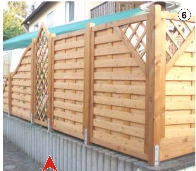
Zaun auf Maß gefertigt, dass die Pfostenanker mittig auf den Betonpalisaden befestigt werden konnten.
